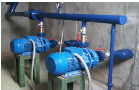
Figura 5. Cuarto bombas hidroneumáticas
