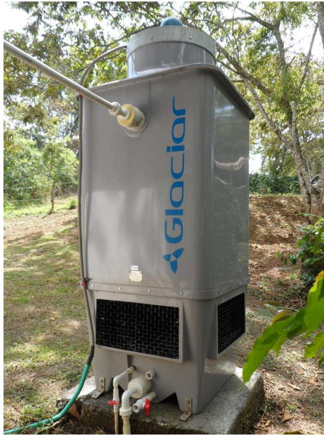
Figura 12. Torre de enfriamiento
