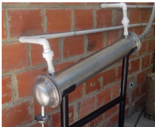
Figura 11. Condensador de tubos y carcasa.
