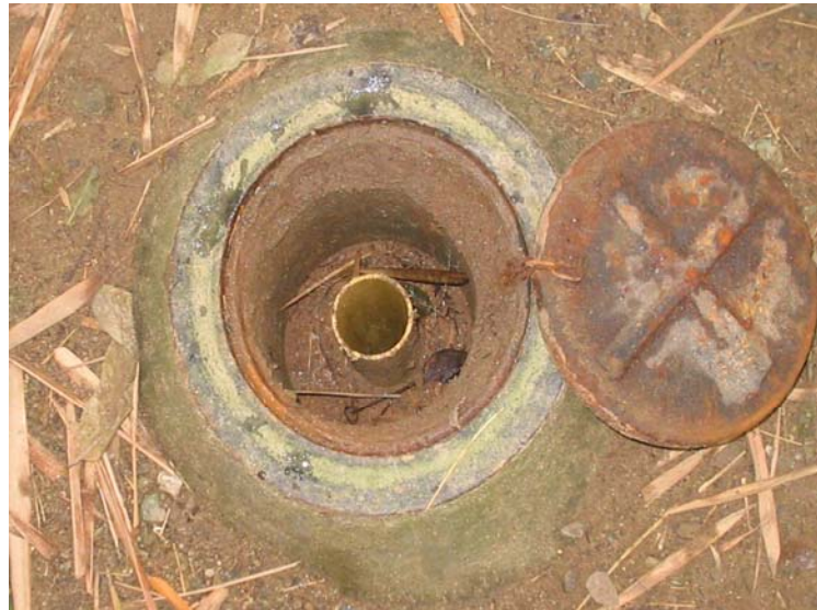
Foto 17. Estación No 5 Piezómetros La Flora Inferior.
