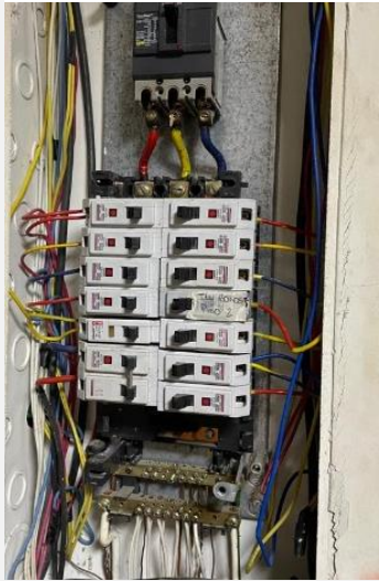
Figura 15 Tablero salones y pasillos
