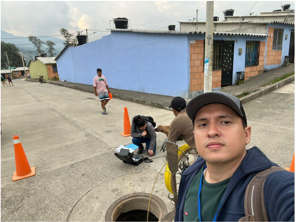
Figura 9-Inspección en proceso barrio prados de sevilla.
