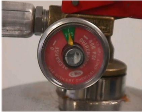
Figura 1.2. Manómetro del extintor
