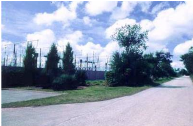
Figura 21. Integración de Subestaciones.
