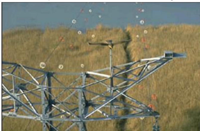
Figura. 22. Disuadores de posada instalados en torre de energía.
