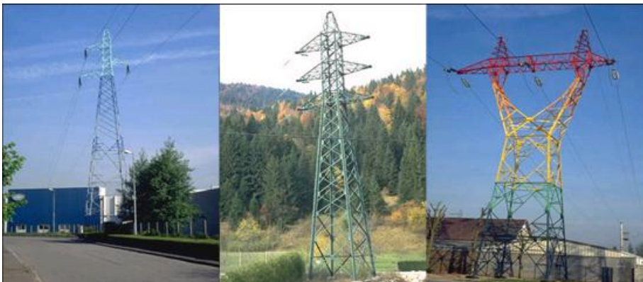
Figura 18. Torres de RTE mimetizadas, según el entorno. Fuente RTE
