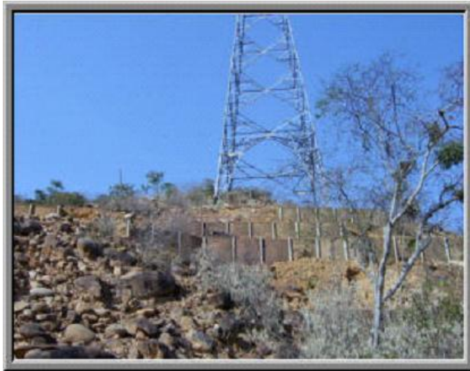
Figura 3. Erosión controlada en sitio de torre
