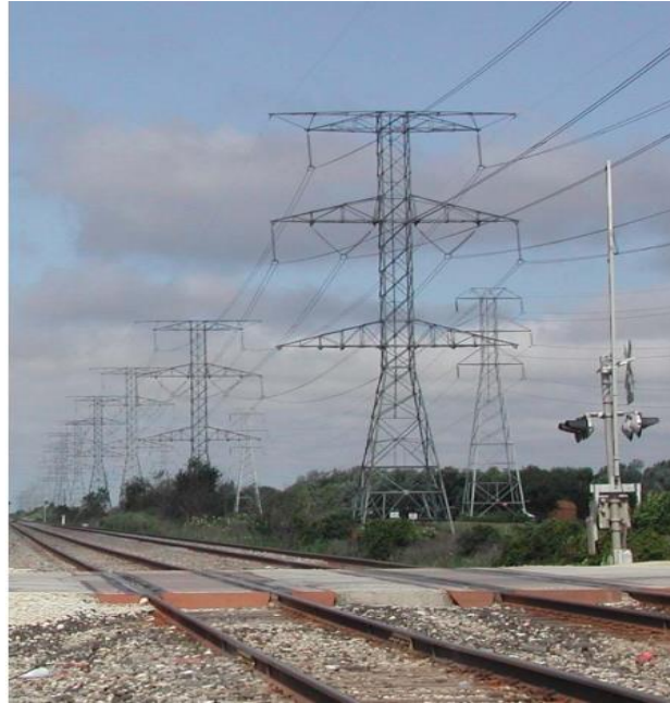
Figura 3. Línea de alta tensión y sistema ferroviario con servidumbre compartida.
