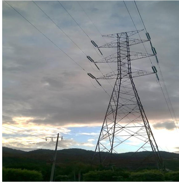
Figura 7. Línea de alta tensión y red de distribución compartiendo zona de servidumbre.
