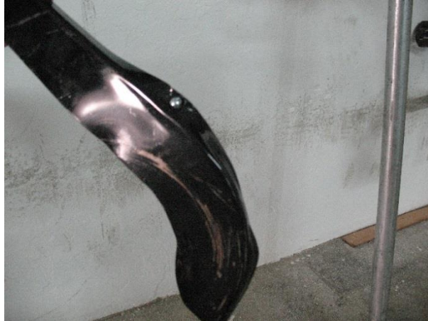
Figura 42 Deformación y pérdida de la tapa protectora de la cadena
