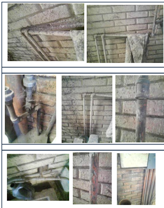
Figura 60. Estado de la red de aire comprimido industrias LAVCO
