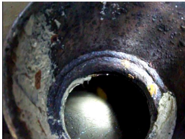
Figura 38. Interior del tanque F024 con ataques de corrosión y oxidación
