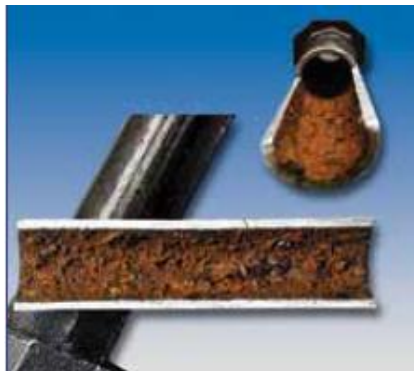
Figura 65. Envejecimiento de la tubería de aire comprimido
