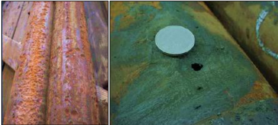
Figura 3. Corrosión tipo Pitting
