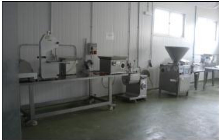
Figura 1: instalaciones del proceso de embutido
