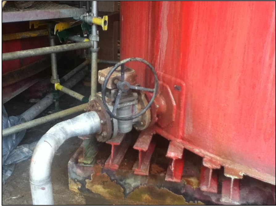
Figura 23. Tanque. Válvula de drenaje
