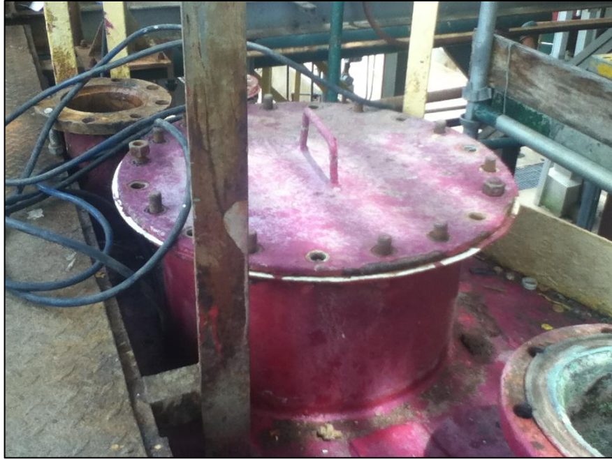
Figura 21. Ciego para acceso a tanque.
