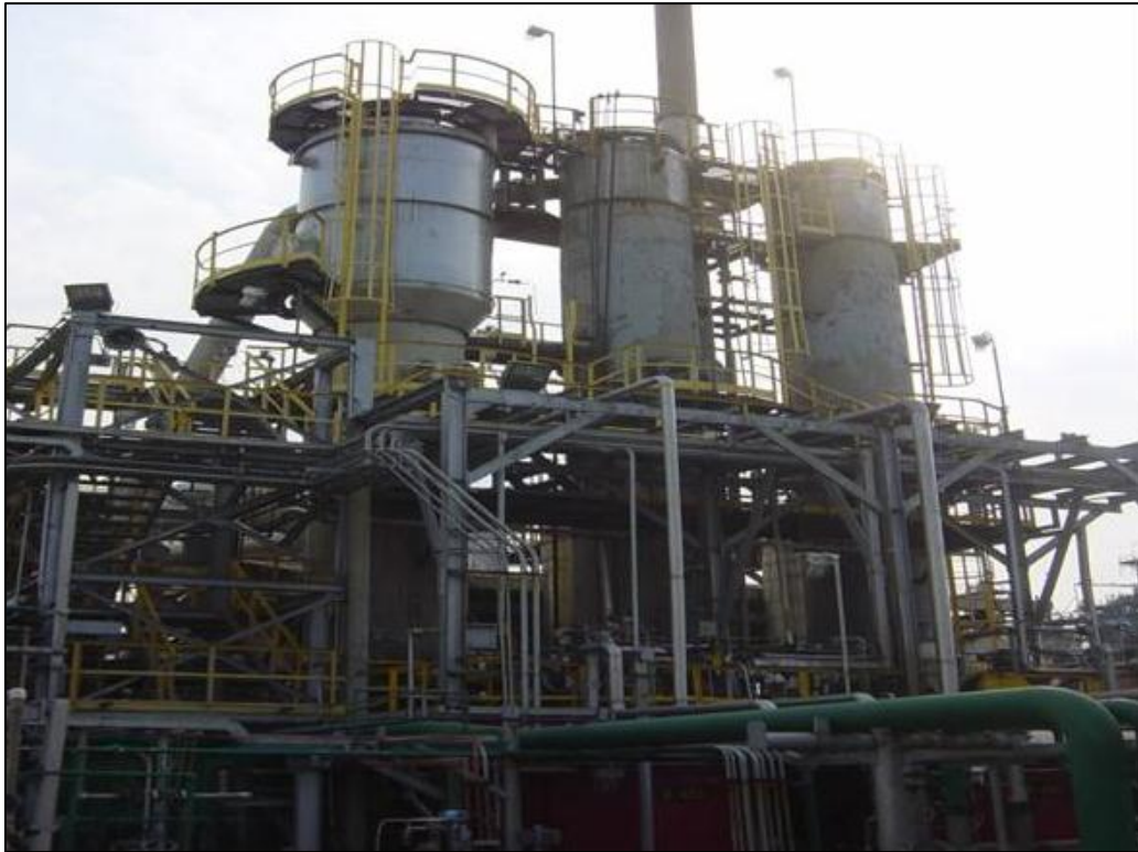
Figura 14. Torre de secado T-482
