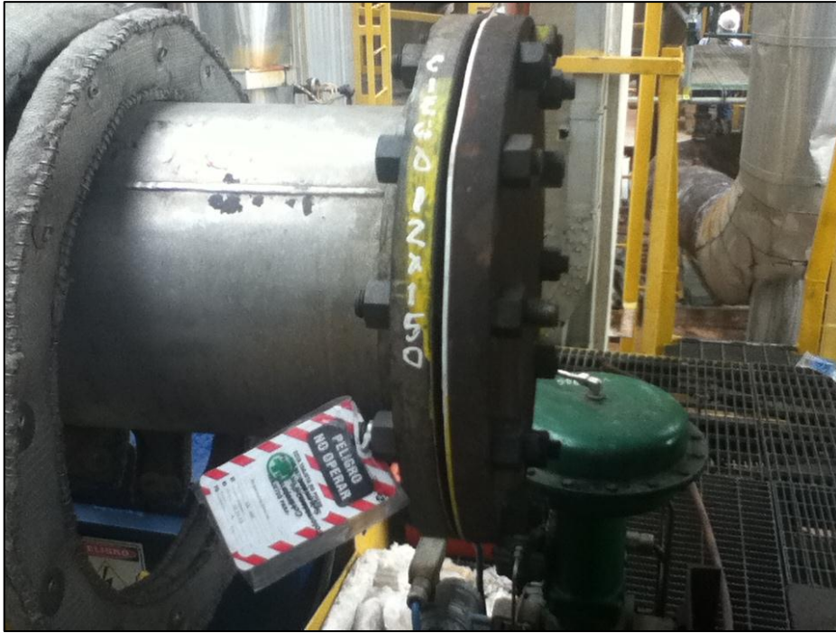
Figura 38. Ciego instalado con tarjeta de seguridad
