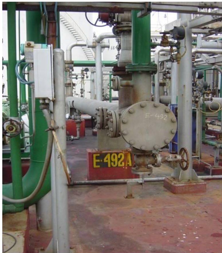
Figura 18. Intercambiador de Calor E-492
