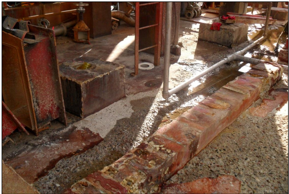
Figura 19. Dique en malas condiciones.
