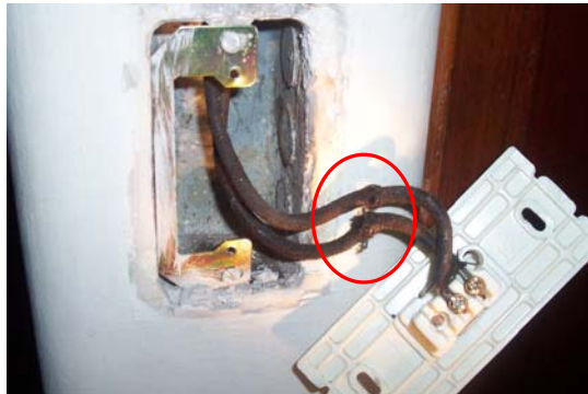
Figura 3.6 Estado del cableado con aislamiento en tela
