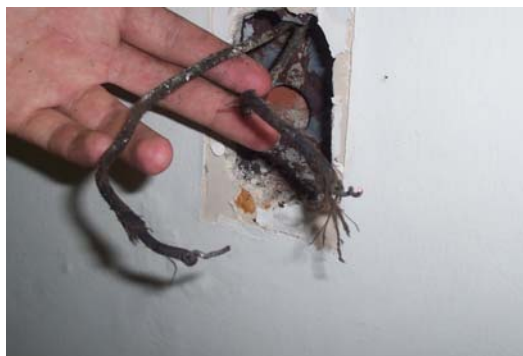
Figura 3.5 Estado del cableado con aislamiento en tela
