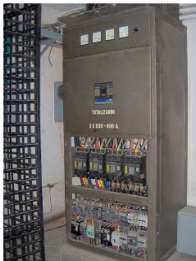
Figura 2.3 Tablero general de acometidas, TGA
