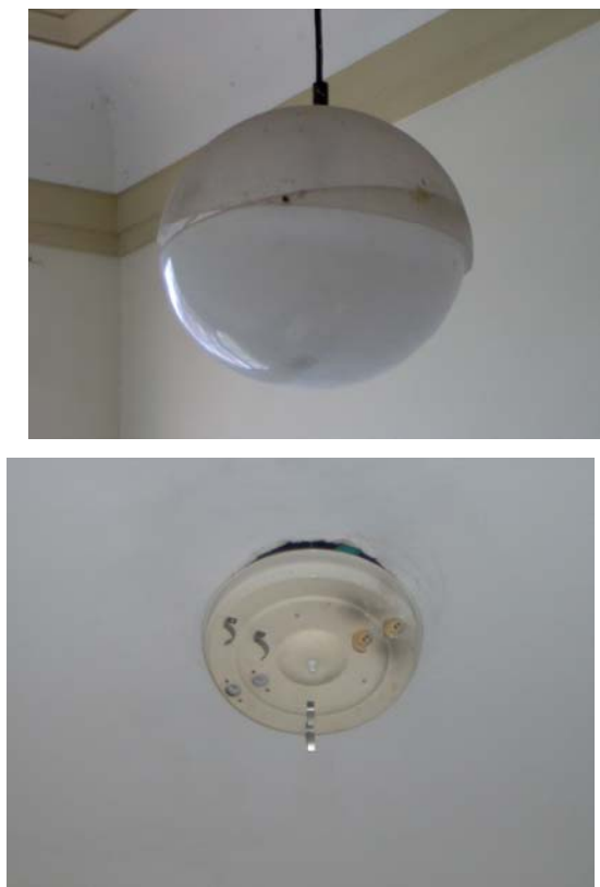
Figura 4.7. Lámparas existentes en mal estado.
