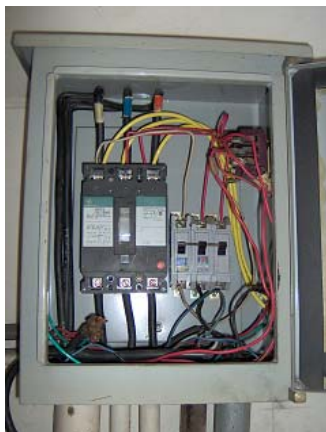
Figura 2.21 Tablero General de baja tensión TGBT7
