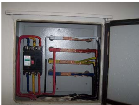
Figura 2.15 Tablero General de baja tensión TGBT2
