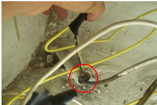
Figura 3.4 Estado del cableado con aislamiento en tela
