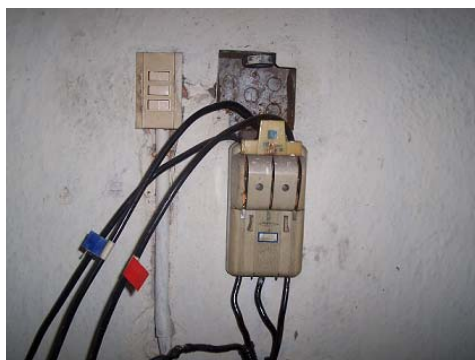
Figura 2.16 Interruptor para el aire acondicionado del Salón Hormiga
