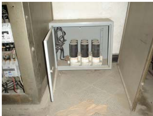
Figura 2.5 Banco de capacitores de 40 kVAR
