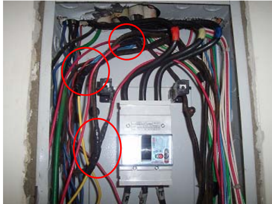
Figura 3.7 Estado del cableado tablero TE1
