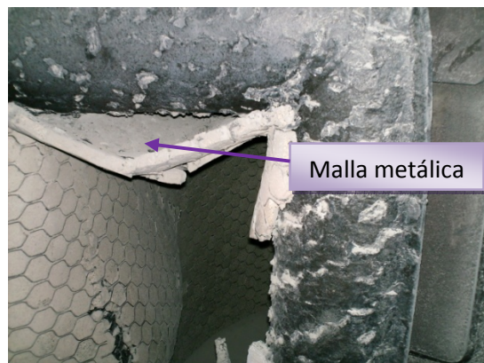
Figura 2: Desprendimiento del anti erosivo en la entrada del ciclón primario (corneta).
