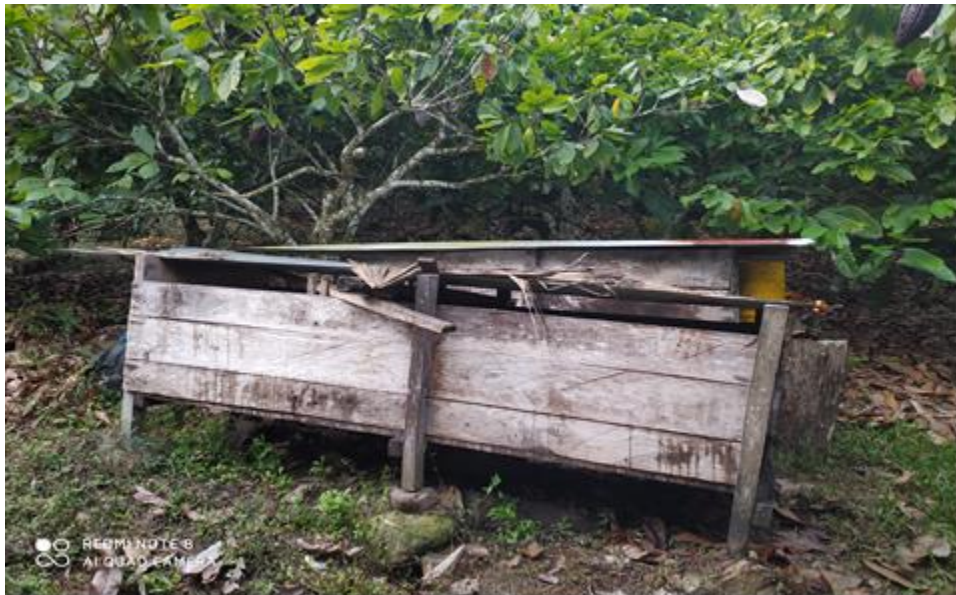
Figura 6. Infraestructura muy Deficiente
