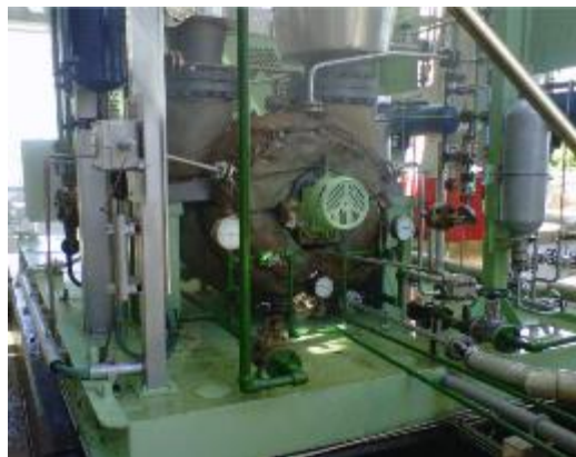
Figura 3. Bombas de Diésel Hidrotratado.
