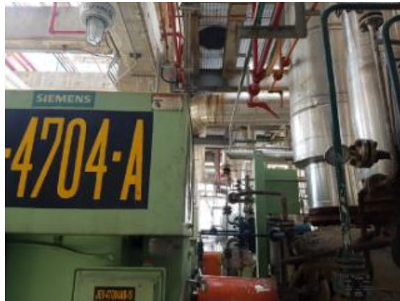
Figura 38. Sistema de diluvio bombas de diesel producto.
