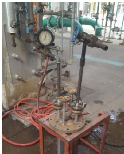
Figura 85. Prueba hidrostática a serpentín.
