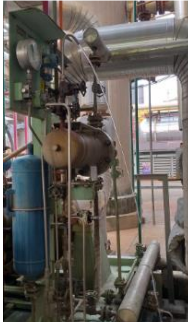
Figura 83. Retrolavado de enfriadores
