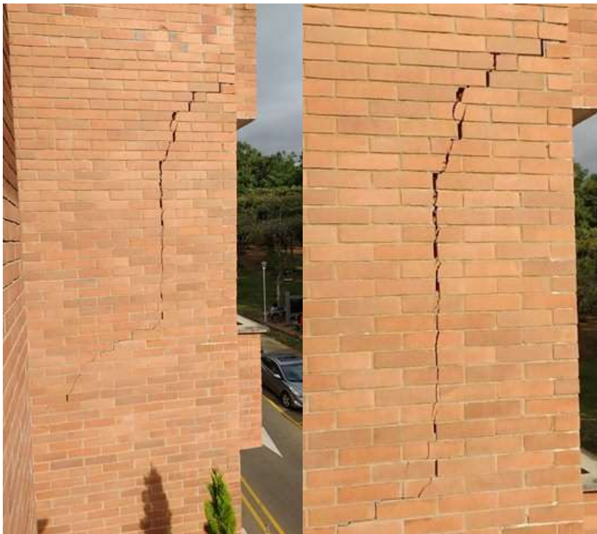
Figura 7. Registro fotográfico de grietas en el cerramiento de los voladizos de la fachada
