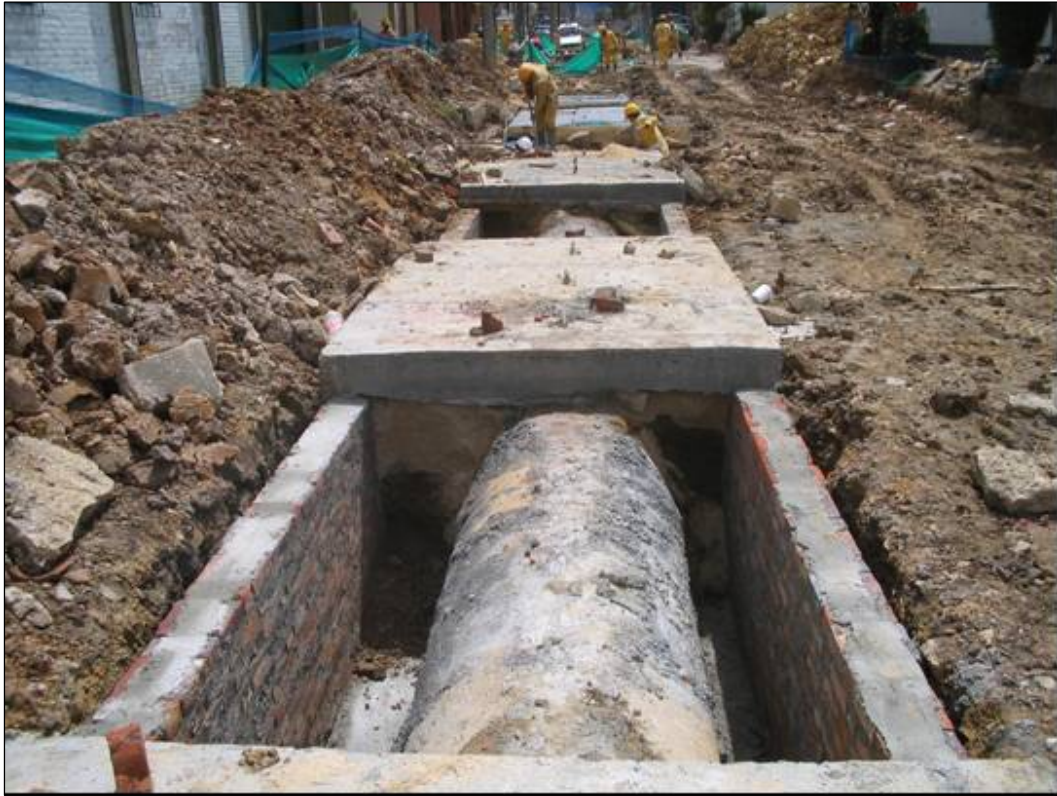
Figura 26. Secciones del carcamo construido por etapas intermitentes para evitar sobrepresiones en la conducción
