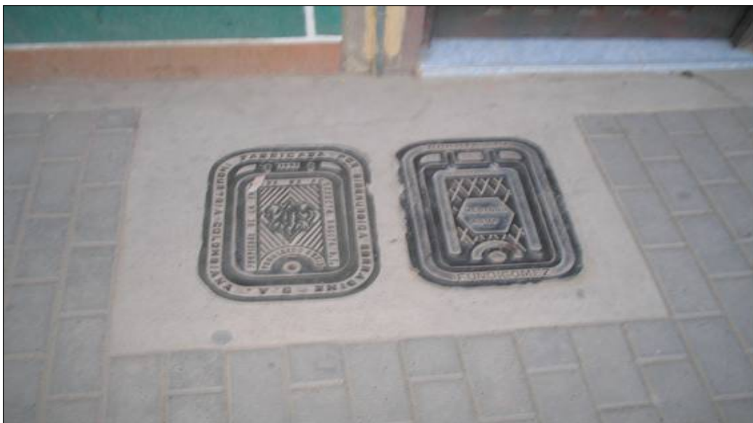
Figura 60. Confinamiento a cajillas de medidores de agua potable
