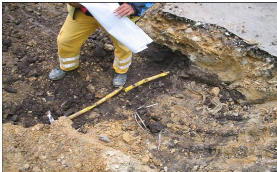
Figura 14. Daño Menor tubería de Gas Natural \phi=3/4''
