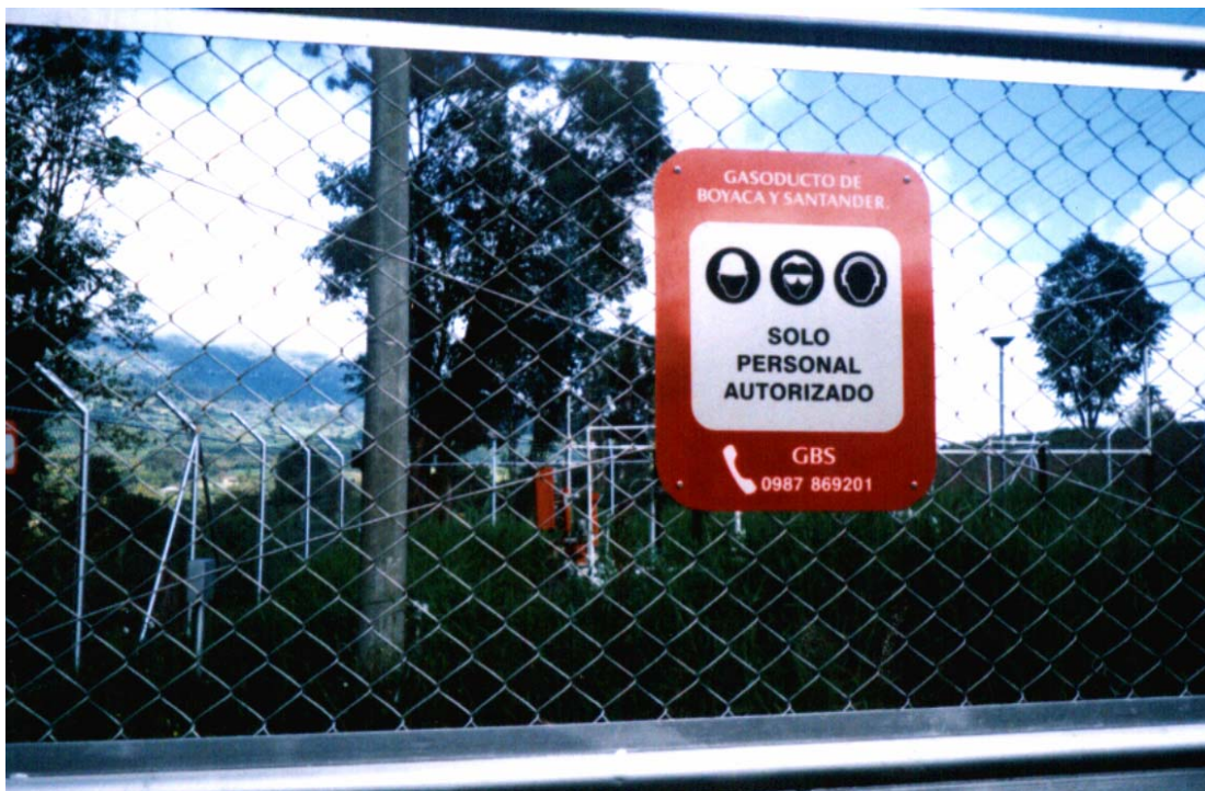
FOTO 3 y 4. Estación City Gate municipio de Chipatá – Santander, propietario ECOGAS, operador GBS – Gasoducto a Localidades de Boyacá y Santander. Punto de derivación de la red de distribución de gas domiciliario.
