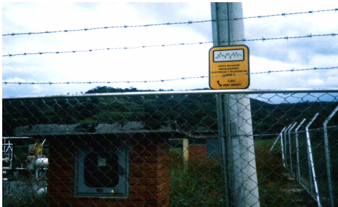
FOTO 7 y 8. Estación City Gate municipio de Bólvivar – Santander, propietario ECOGAS, operador GBS – Gasoducto a Localidades de Boyacá y Santander. Punto de derivación de la red de distribución de gas domiciliario. Se aprecia los equipos incluidos en el City gate y parte de la señalización de seguridad.
