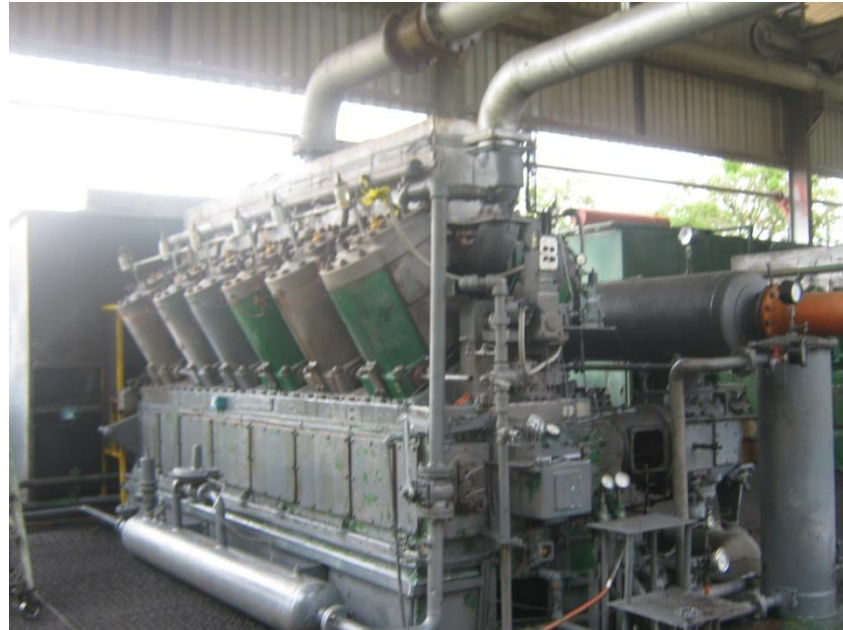
Figura 18: Compresor INGERSOLL de baja (LP1) campo Cicuco.
