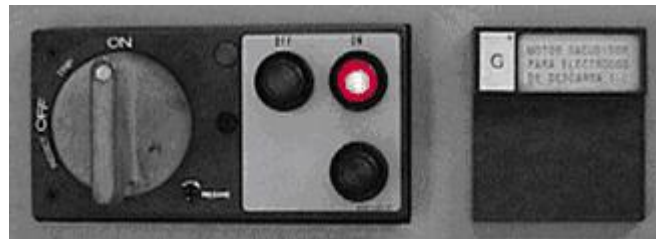
Figura 20. Estación de arranque parada.
