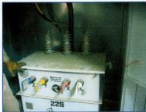
Ilustración 1 Transformador antes de su Mantenimiento
