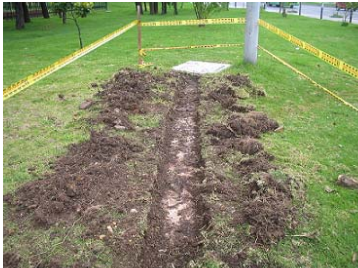
Fotografía 1. Canalización en zona verde con la respectiva señalización
