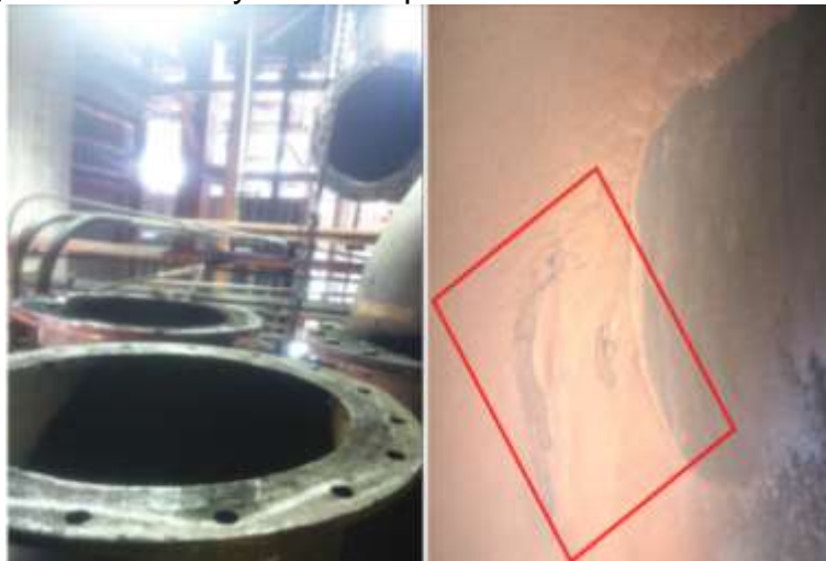
Figura 30. Desgaste en codos y ductor superiores.
