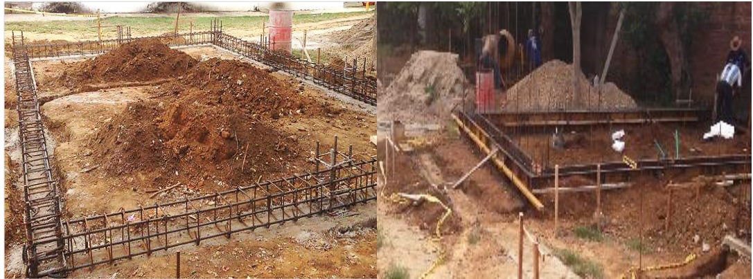
Figura 11. Cimentación de elementos de amarre de los módulos exteriores de bienestar universitario
