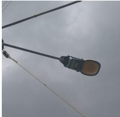
Imagen 11. El difusor de la luminaria está sucio
