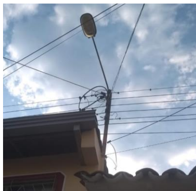
Imagen 10. El soporte de la luminaria es inadecuado además está adherido a una vivienda.
