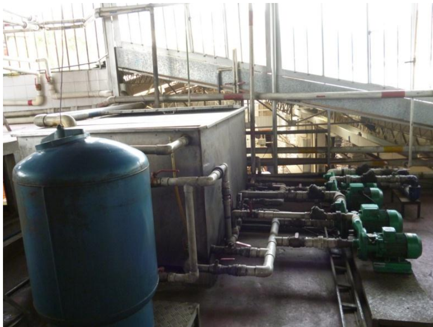
Foto 5. Tanque de acero y filtro de arena
