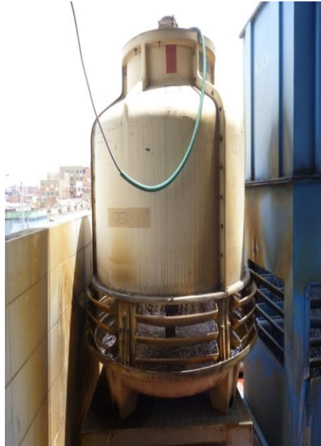
Foto 4. Torre de enfriamiento de tiro inducido
