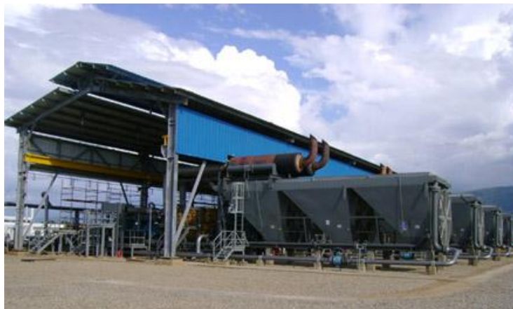
Figura 7. Estación compresora Jagua del Pilar
