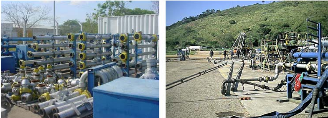
Figura 18. Líneas de alta presión
