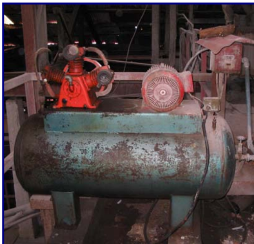
Figura 31. Compresor del Sistema de Lubricación del Molino de Barras.
