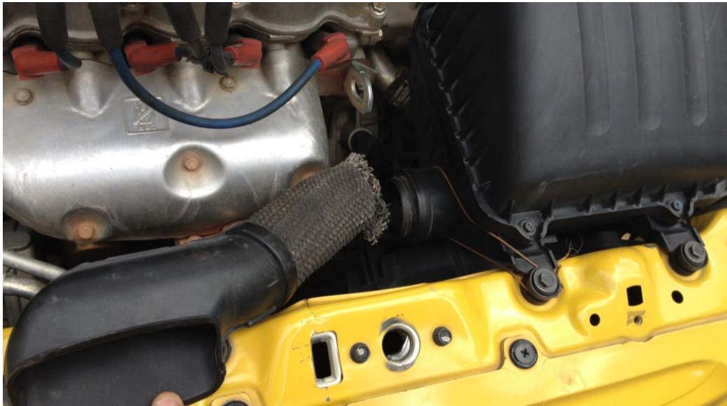
Figura 30. Ducto hacia filtro de aire en mal estado
