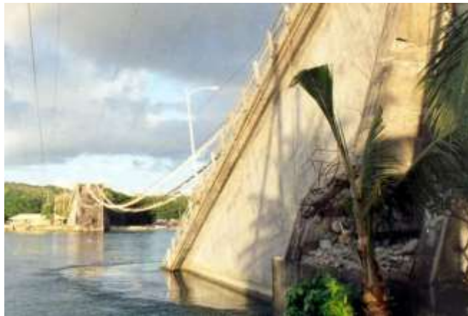
Figura 4. Puente de Koror – Babeldaop tras colapsar. Tomado de (WJE Projects, n.d.)
