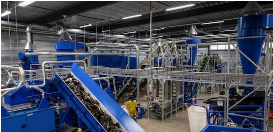
Figura 18. Actuales instalaciones de FastFeetGrinded
