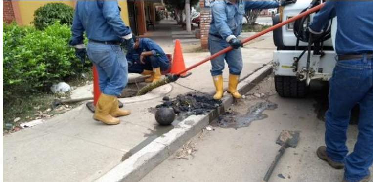
Figura 5 Red sanitaria destapada en el Barrio Portal Campestre.
