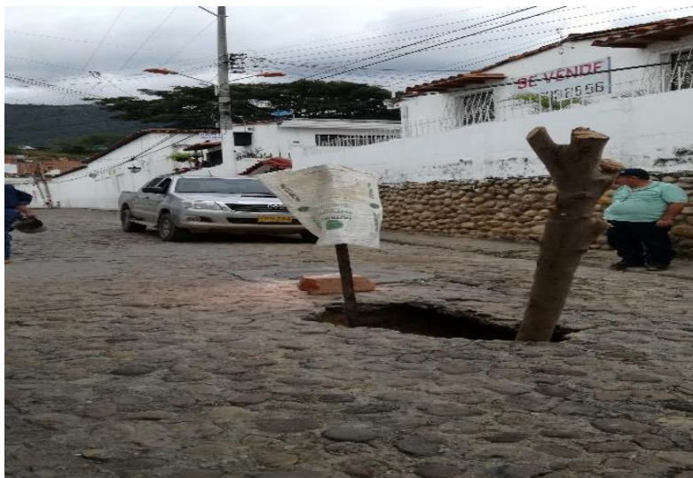
Figura 9 Hueco por caída del pavimento en el Barrio Llanito II
