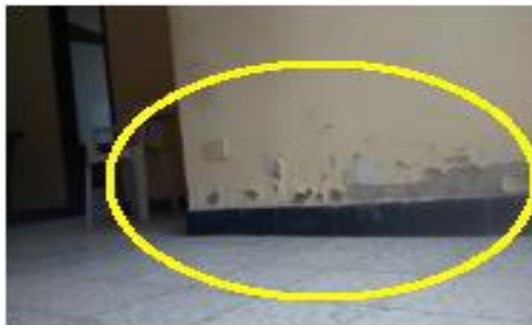
Figura 1 humedad de paredes y pintura en mal estado.
