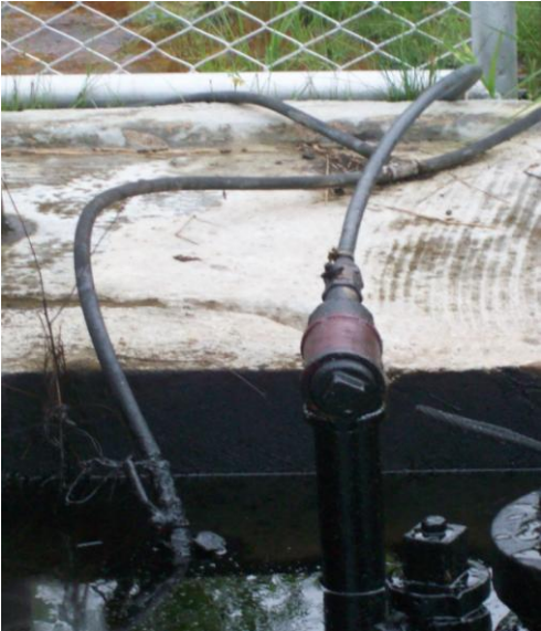
Figura 8. Fotografía Pozo Cira 0575
