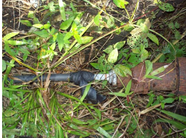
Figura 6. Fotografía Pozo Cira 0243
