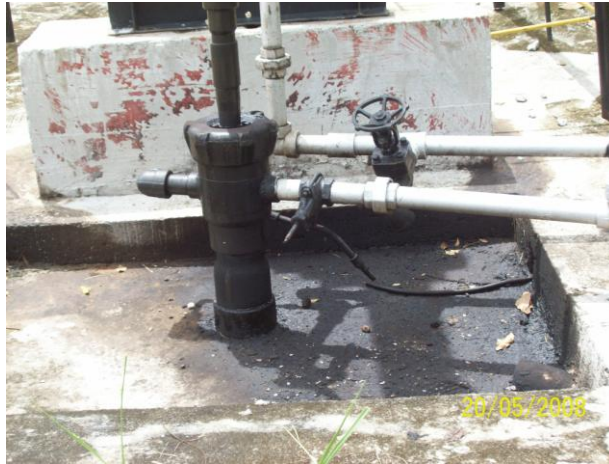
Figura 10. Fotografía Pozo Cira 1566
