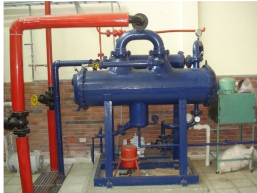
Figura 6. Condensador de superficie
