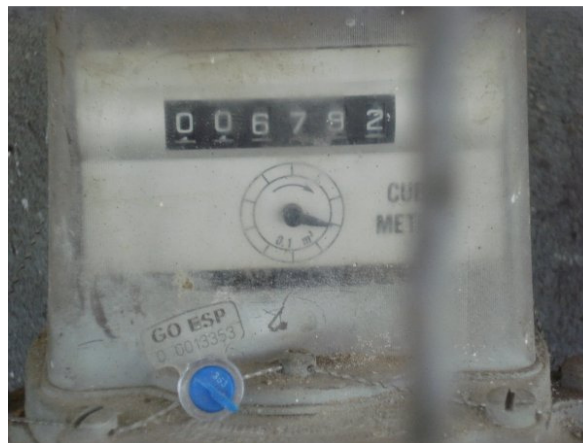
Figura 32. Contador de gas natural.
