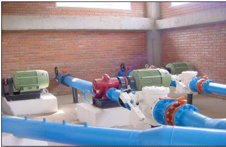
Figura 19. Estación de bombeo
