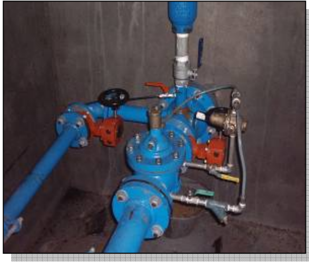
Figura 17. Estación reguladora de presión (foto)
