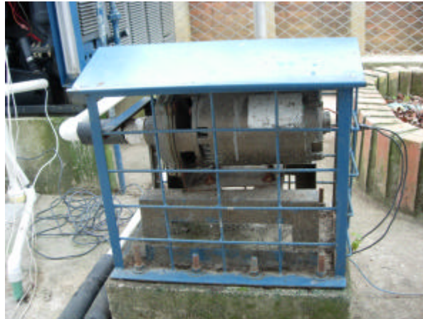
Figura 14. Bomba de agua fría
