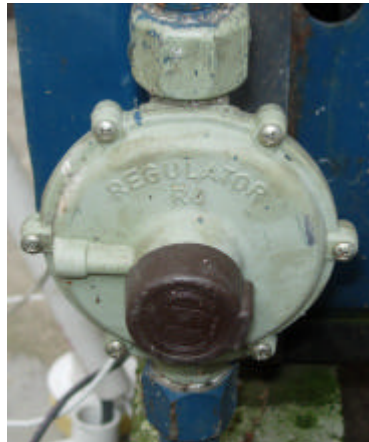
Figura 17. Válvula reguladora de presión de gas.
