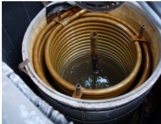
Figura 13. Tanque de enfriamiento del agua.
