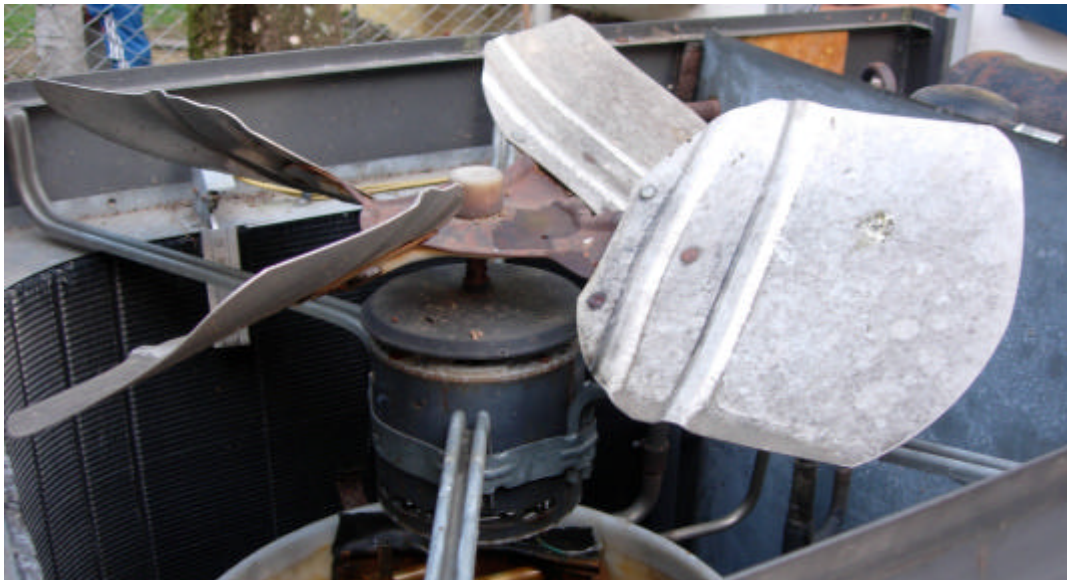
Figura 27. Ventilador de la unidad
