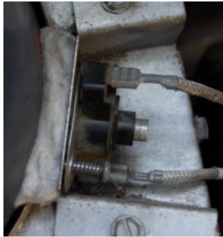
Figura 21. Interruptor de alta temperatura del generador
