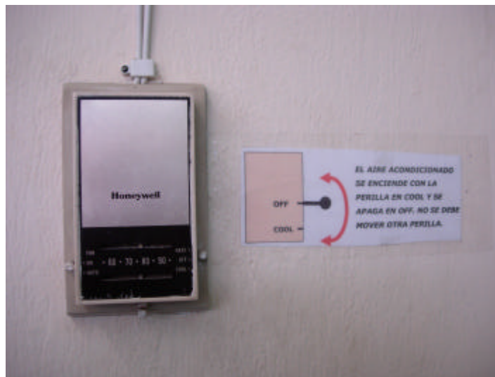
Figura E1. Termostato del cuarto.
