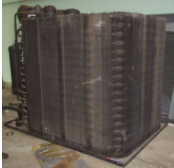
Figura 32. Serpentina del condensador absorbedor
