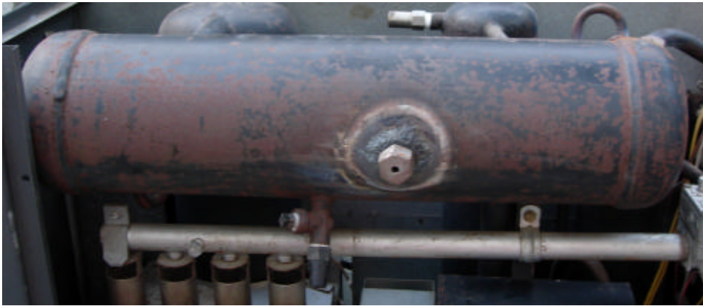
Figura 11. Cámara niveladora de la unidad ROBUR.
