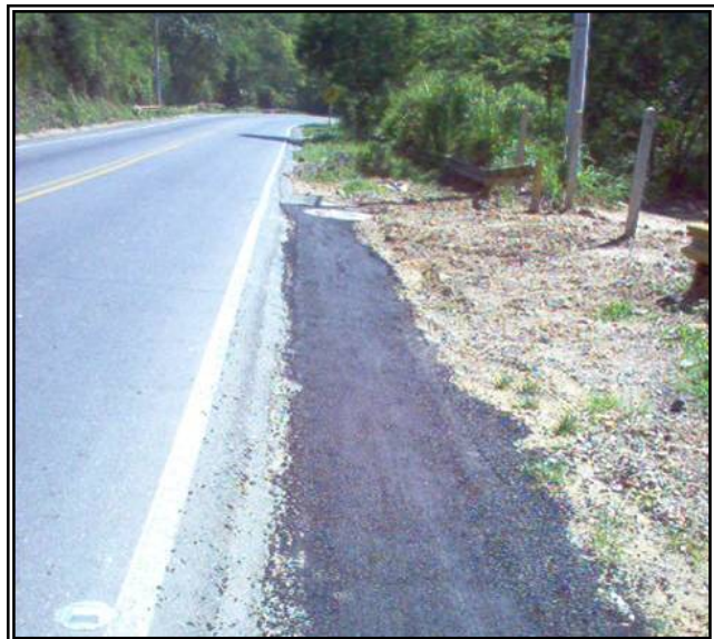
Figura 72. Berma Recuperada, Contrato No. 5121 – 01.
