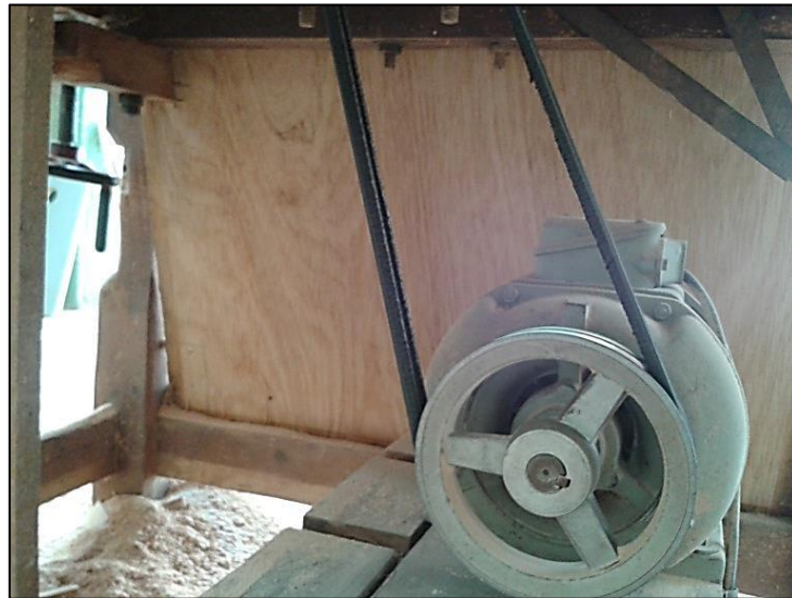
Figura 2. Sistema de Transmisión de potencia sin guarda de seguridad
