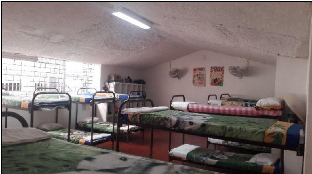
Figura 3. Alojamiento con presencia de humedad en la cubierta.
