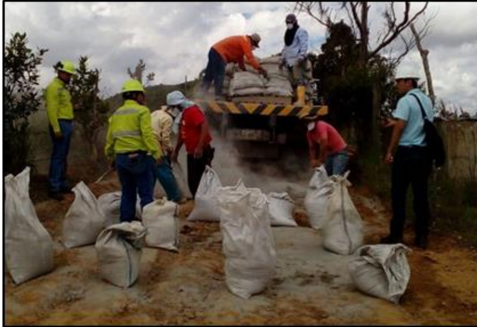
Figura 8. Cemento sobre la vía.
