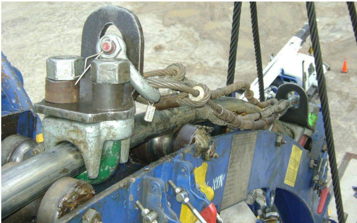
Figura 83. Falla de la tubería ocasionada por la curvatura del cuello de ganso
