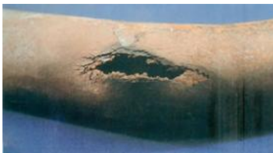
Figura 77. Falla de la tubería en superficie ( Pin Hole )
