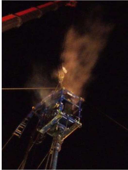
Figura 82. Fuga en el stripper
