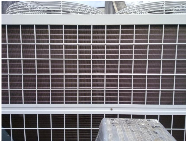
Figura 32. Intercambiador de calor de la condensadora
