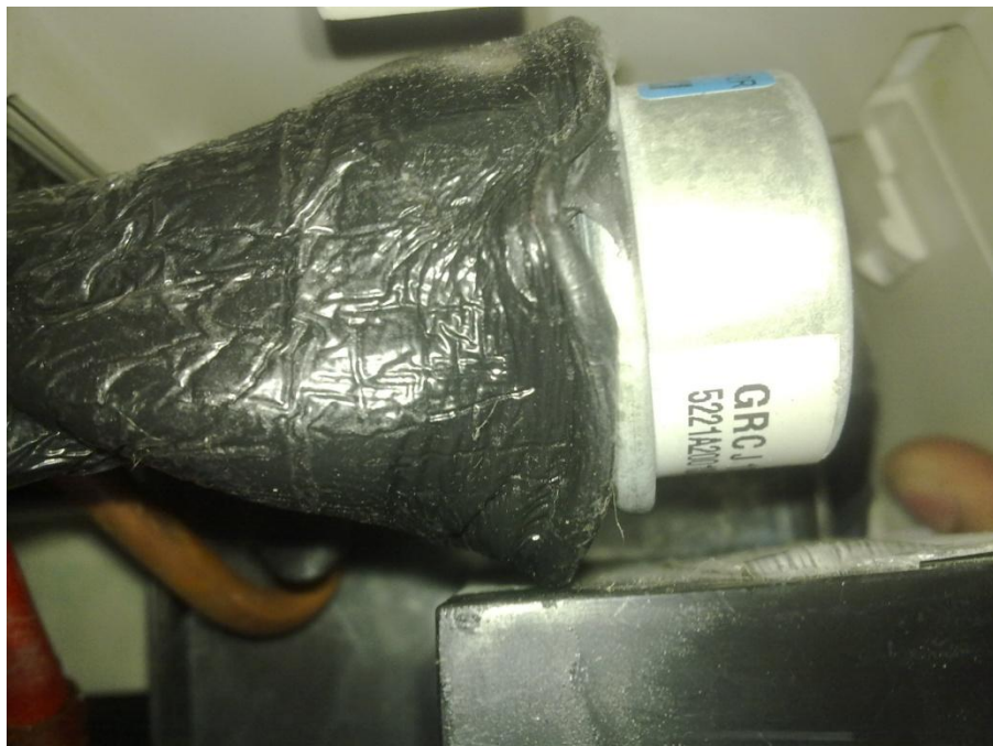
Figura 39. Válvula de expansión electrónica de la evaporadora
