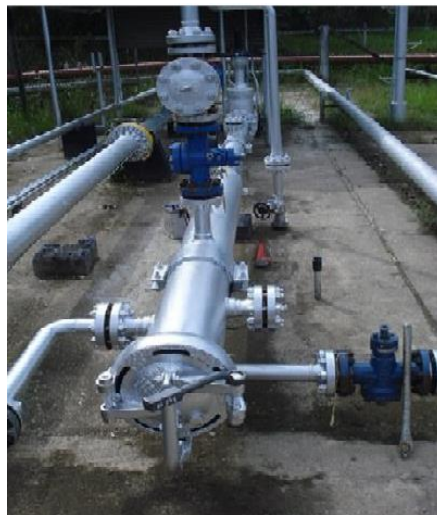
Figura 5. Trampa de recibo estación Payoa gasoducto Bucaramanga-Payoa 6"
