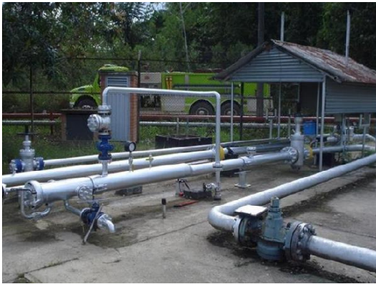
Figura 6. Trampa de recibo estación Payoa gasoducto Bucaramanga-Payoa 6"
