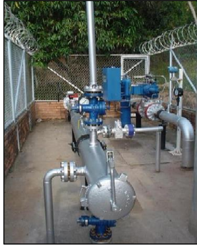
Figura 2. Trampa de lanzamiento estación Águilas-Giron gasoducto Bucaramanga-Payoa 6"
