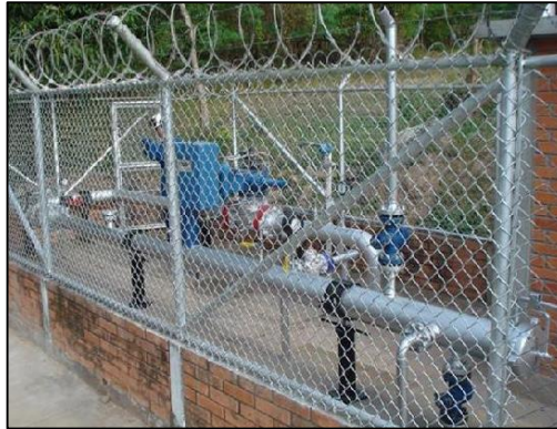
Figura 3. Trampa de lanzamiento estación Águilas-Giron gasoducto Bucaramanga-Payoa 6"
