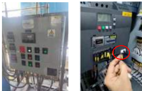
Figura 4. tablero de control y protecciones capota
