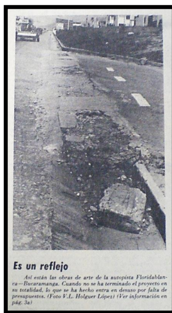
Fotografía 14 .Daños de obras de arte en la Autopista Bucaramanga- Floridablanca
