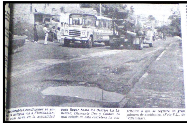
Fotografía 22. Deplorable estado de la Vía Antigua hacia el Municipio de Floridablanca
