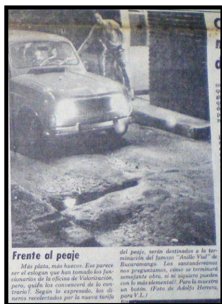
Fotografía 13. Mal estado del pavimento en el peaje de la Autopista Bucaramanga-Floridablanca
