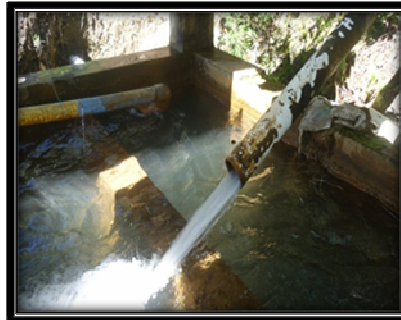
Fotografía 18. Conducto de aducción
