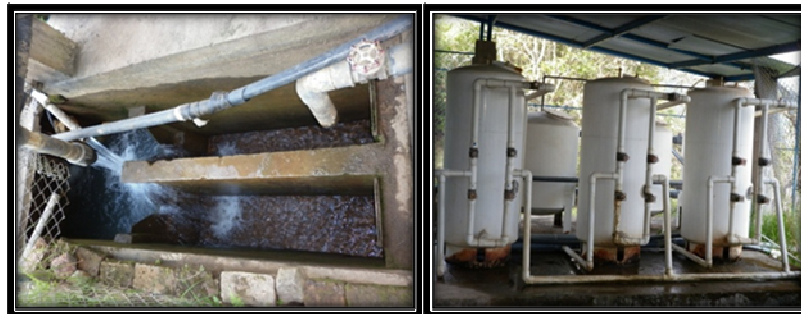
Fotografía 9. Caja de Aquietamiento Fotografía 10. Floculación, sedimentación Y filtración granular (fuera de servicio)
