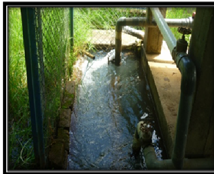
Fotografía 21. Caja de aquietamiento
