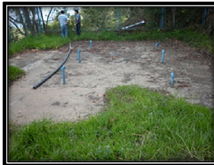
Fotografía 13. Tanque de Almacenamiento
