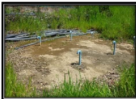
Figura 20. Tanque de almacenamiento
