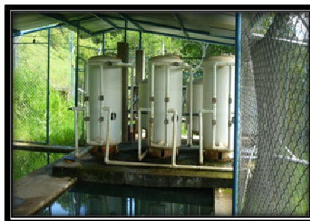
Fotografía 23. Sistema de filtración
