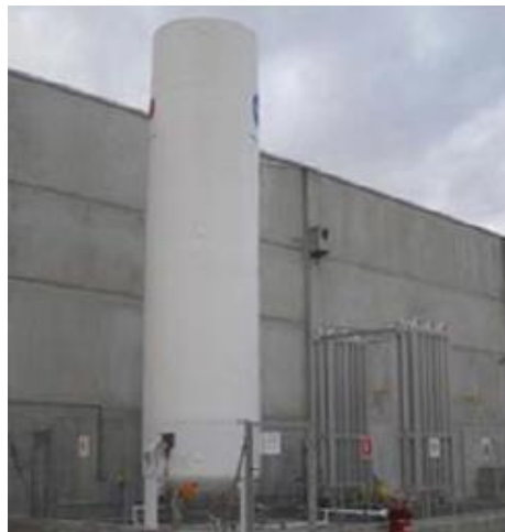
Figura 40. Depósito criogénico vertical.
