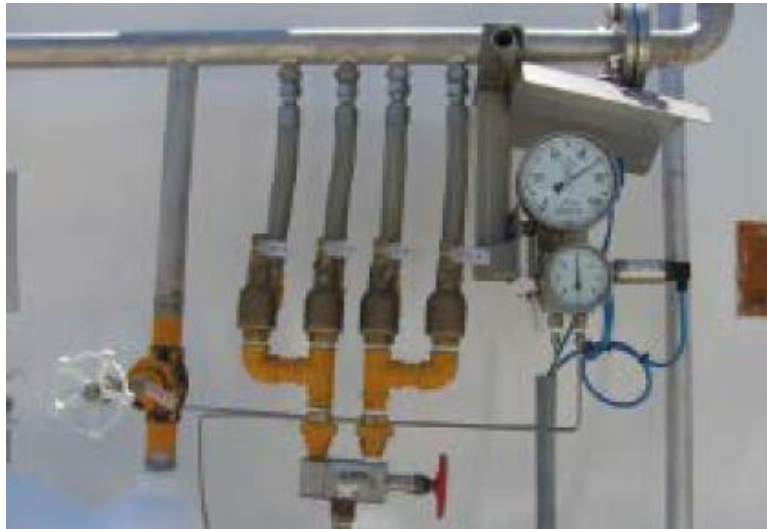
Figura 43. Válvulas de seguridad.
