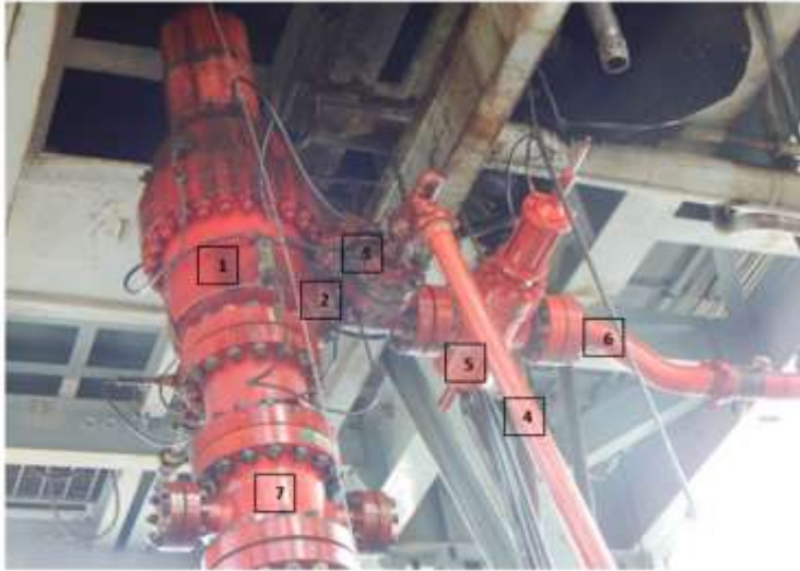
Figura. 37. Rig up de la Cabeza Rotatoria Modelo 780 de 13- 5/8", Línea de flujo y accesorios.
