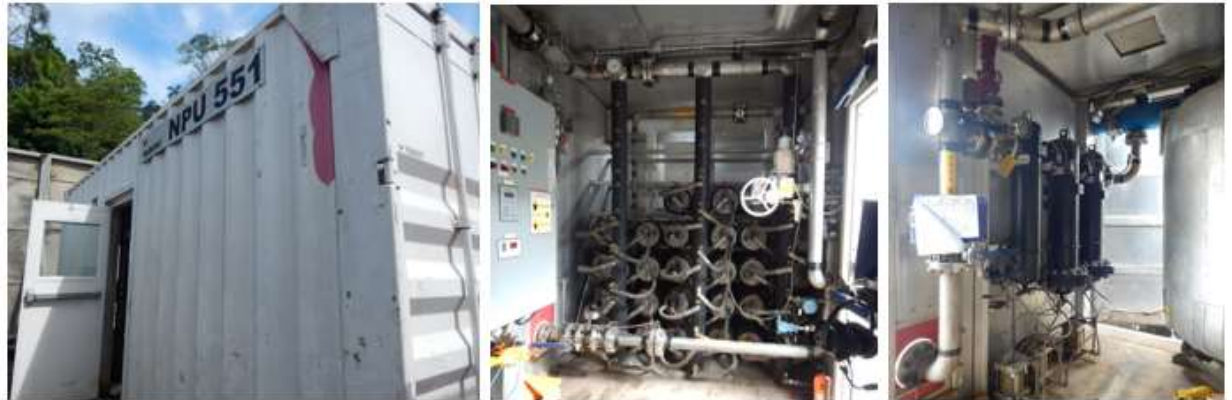
Figura. 9. Unidad generadora de nitrógeno tipo membranas.
